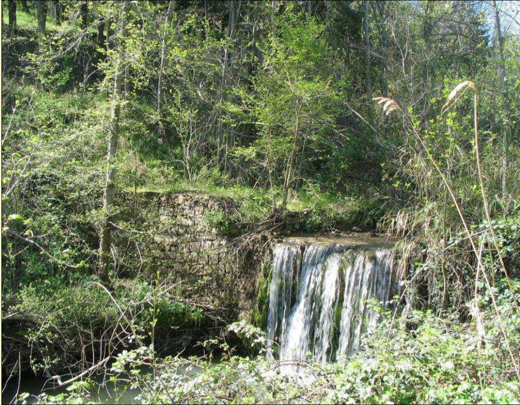
Foto Briglia in gabbioni (Torrente Cammarota, Comune di Deliceto (Fg) Foto M. Frisoli)
