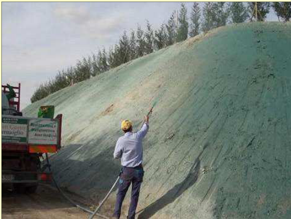
Inerbimento di scarpata Foto M. Frisoli
